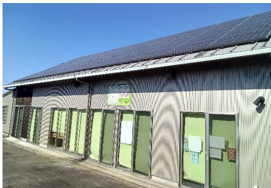
写真 10 屋根上太陽光（小美玉市部室）
