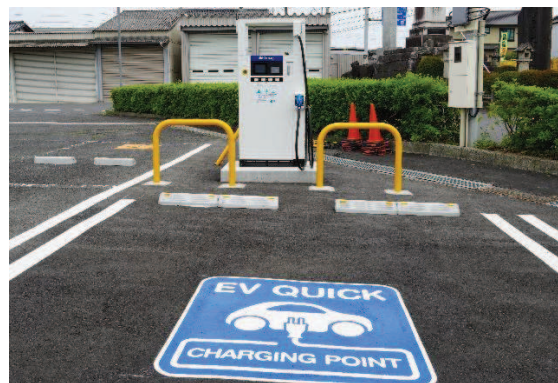
写真 4 EV 急速充電器 (市役所本庁舎前の駐車場)
