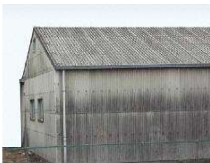
石綿含有吹付けロックウール
