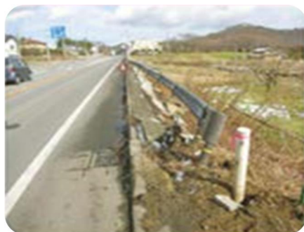
ガードレール・ 標識等の損傷
