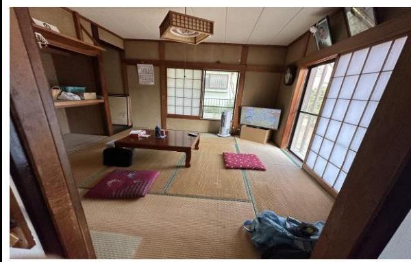
和室② (傾きあり)
