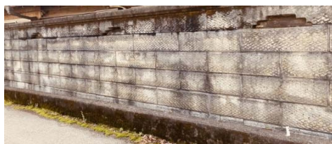
危険なブロック塀の撤去等に補助します
